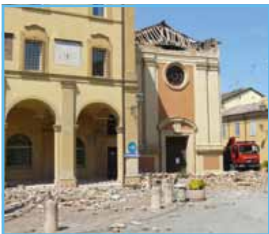
L'Oratorio di Piazza Matteotti ha subito danni gravi
